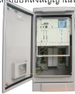
ตู้ควบคุมสัญญาณไฟจราจร
