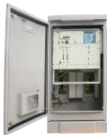
ตู้ควบคุมสัญญาณไฟจราจร
